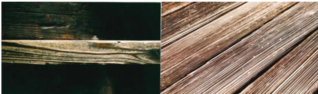
写真 14 スギの床板の目やせ
