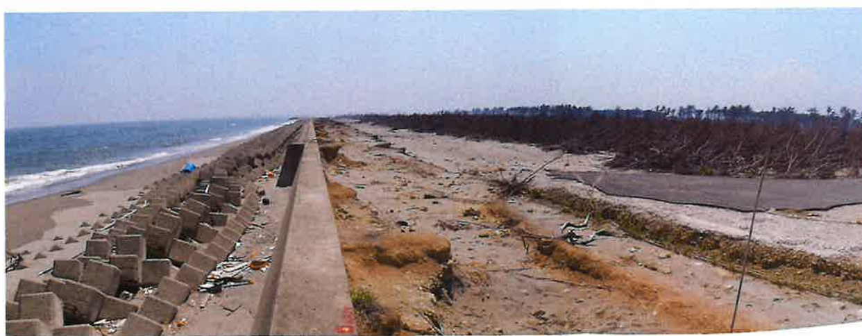
平野部の被害状況（仙台平野：井土浜）
