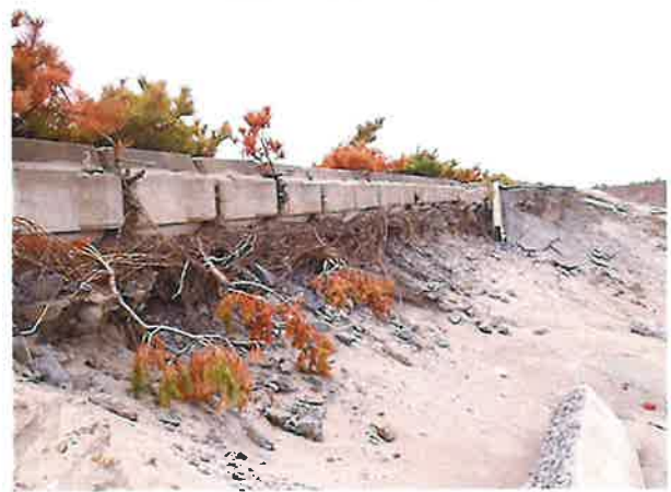
防潮堤裏の破壊
