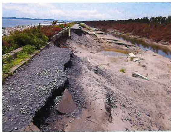
写真11 被災した防潮堤水裏
