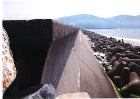
写真6 被災を免れた直立型防潮堤
